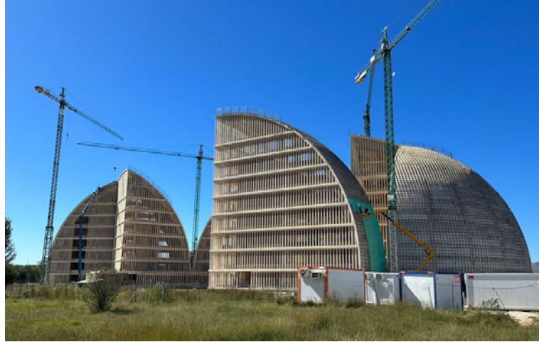
Figura 3. Cúpulas de la energía, Garrañeta (Soria) (Fuente: GRUPO HERCE)
