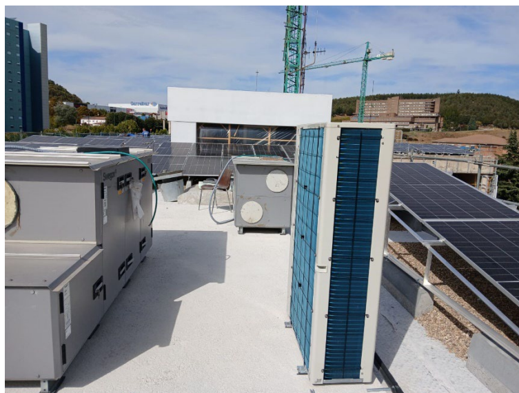
Figura 6. Vista de la cubierta de un edificio con recuperadores, climatizadores, paneles solares. Fuente propia.
